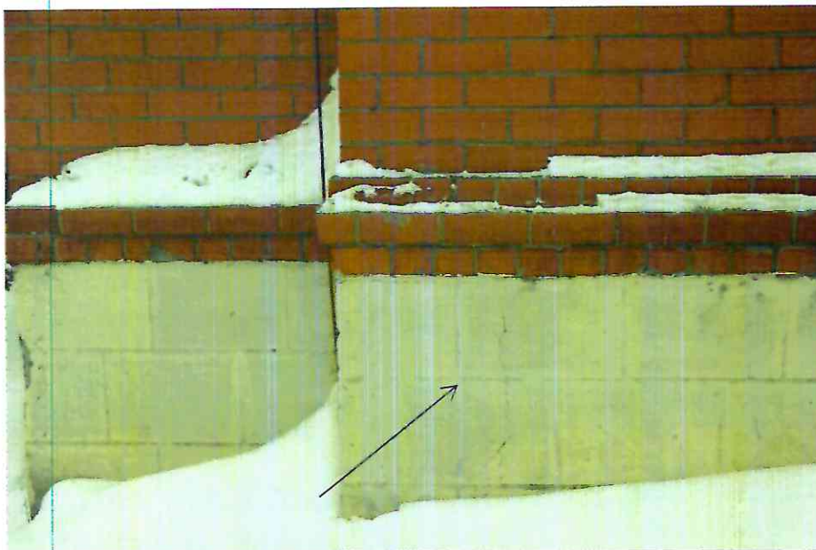
Фото №6. Трещина в цоколе, слева-стенка лоджии.
