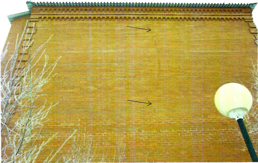
Фото №4. Трещина на лицевом слое кладки торца здания ориентации Ю-Ю-В.
