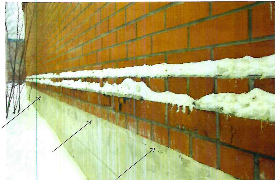
Фото №5. Деградия от времени защитных поясков из раствора выступающих частей кладки с закономерным разрушением стенок камней.
